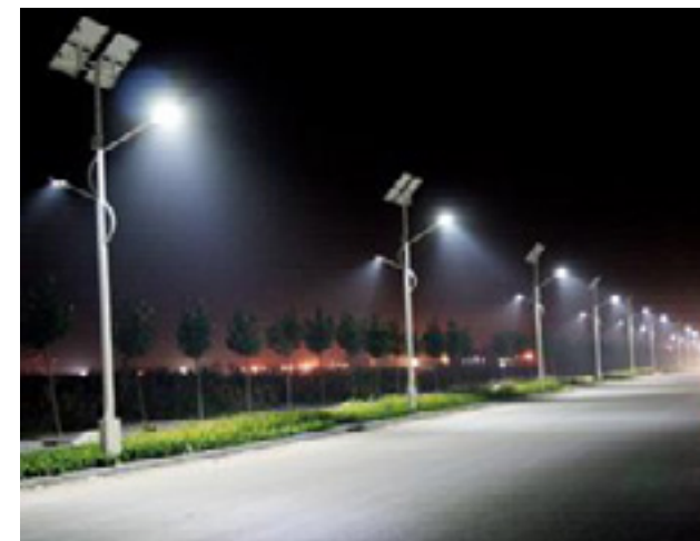
Image 7 : Ce lampadaire solaire éclaire le réseau viaire et la voie de circulation dédiée aux piétons. (Source : ledosaure.fr)
